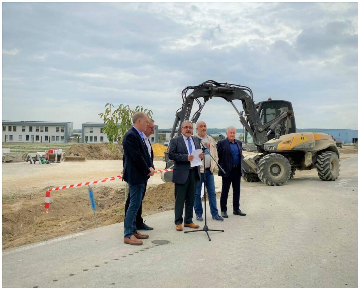
Les élus du Grand Avignon lors du lancement des travaux le jeudi 20 octobre. DR
