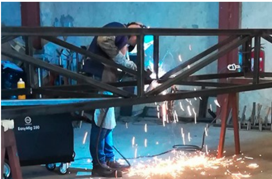
Réalisation d'un rack au sein de l'entreprise Massin et associés.
