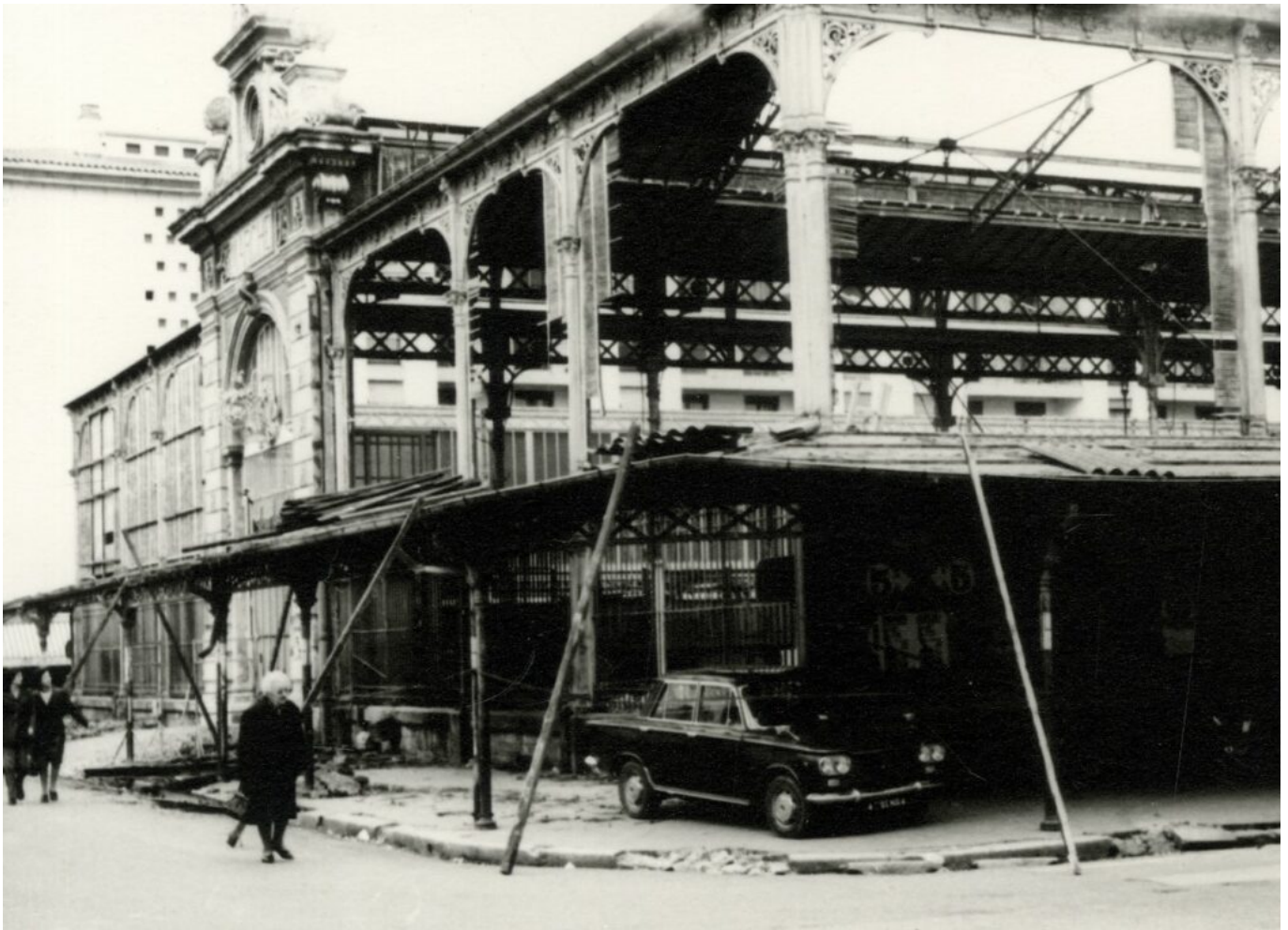
Les Halles en cours de démolition en 1972. Fond privé. Archives municipales. Anonyme. Photographie, 13X18
