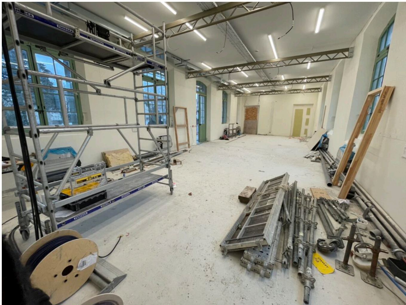
Une des quatre galeries de 110m2 en cours de finition Copyright MMH
