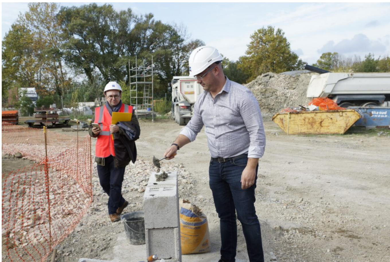
Yann Bompard, maire de la ville d'Orange, pose la première pierre de la nouvelle station d'épuration de Jonquières © DR
